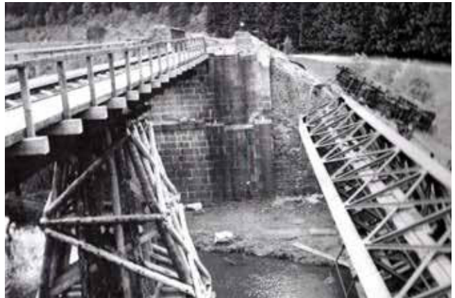
Zerstörte Eisenbahnbrücke bei Helenenthal.
